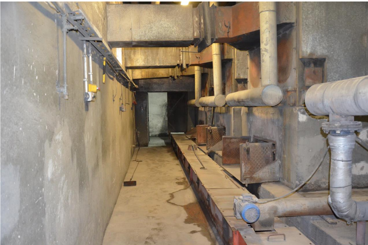
Istniejący przenośnik zgrzeblowy do demontażu
