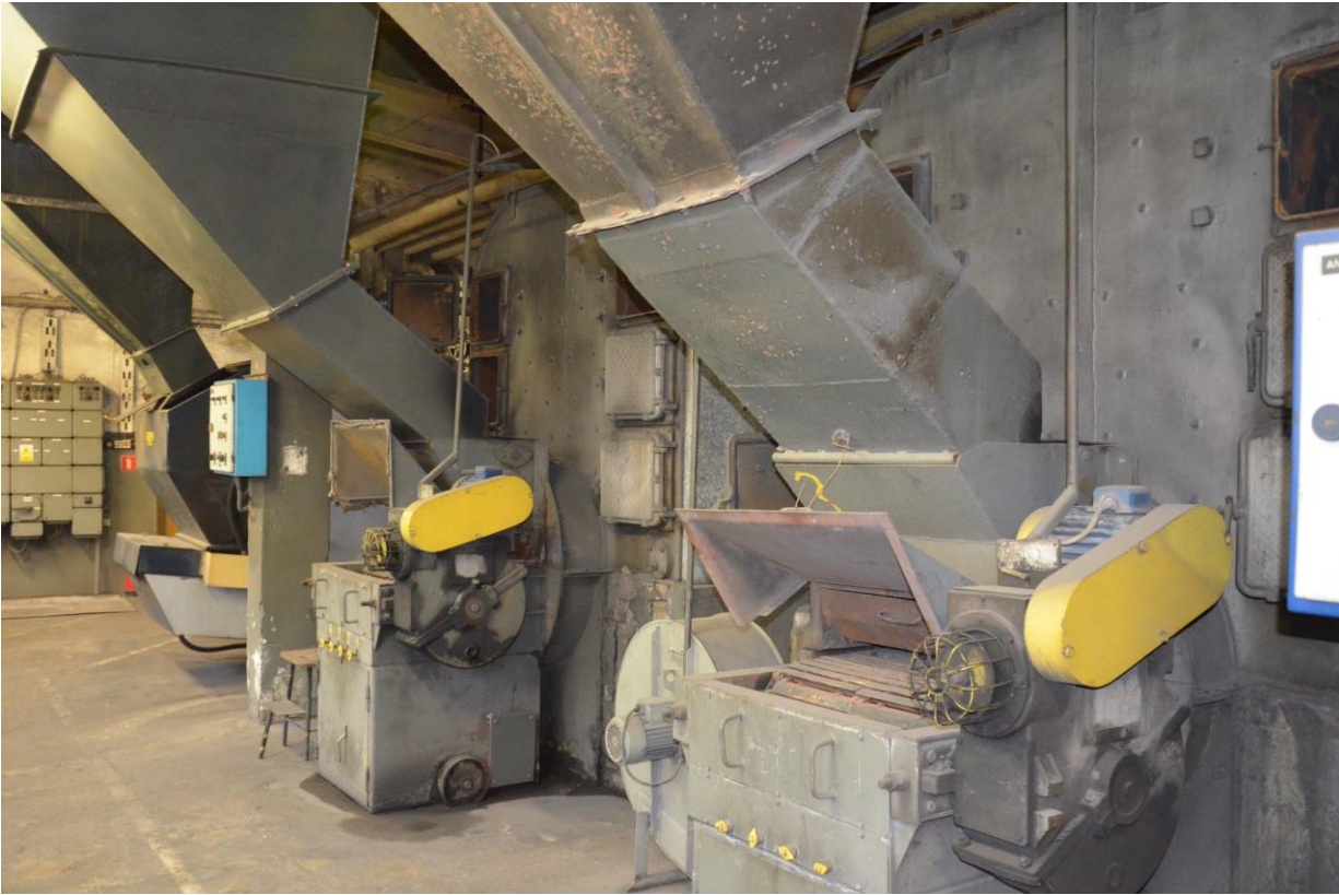
Kotły SWC 900 przeznaczone do demontażu
