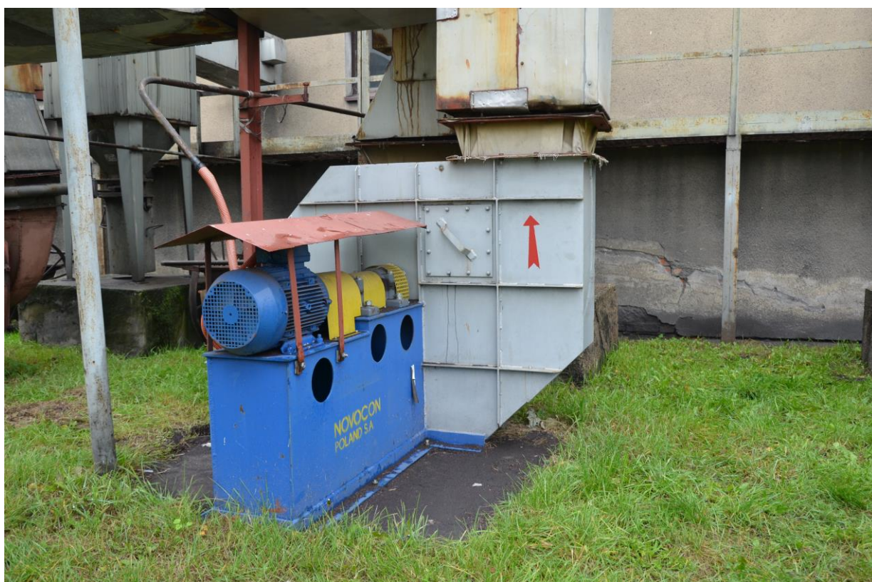
Istniejący wentylator wyciągu spalin
